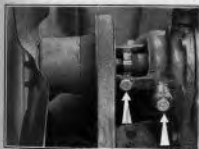
Axe du ventilateur et de la pompe à eau. "S".
